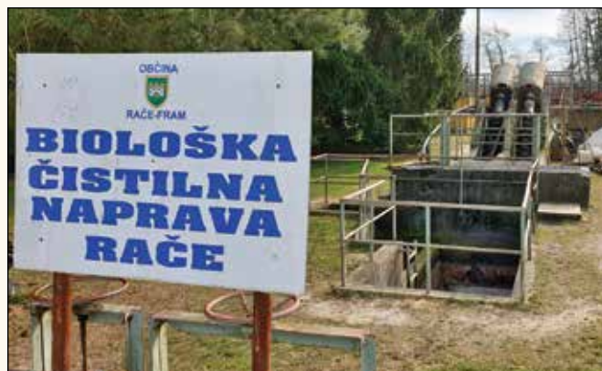
Obstoječa biološka čistilna naprava v Račah Foto: S. A.
